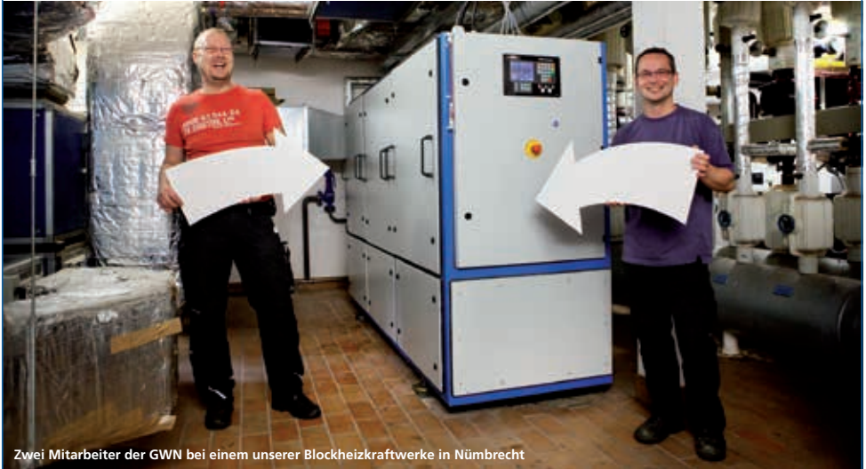
Zwei Mitarbeiter der GWN bei einem unserer Blockheizkraftwerke in Nümbrecht
