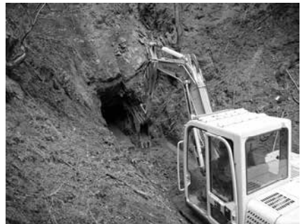
Mit einem Bagger wurde das verschüttete Mundloch des alten Bergwerksstollens bei Morsbach vorsichtig freigelegt. Foto: C. Buchen
